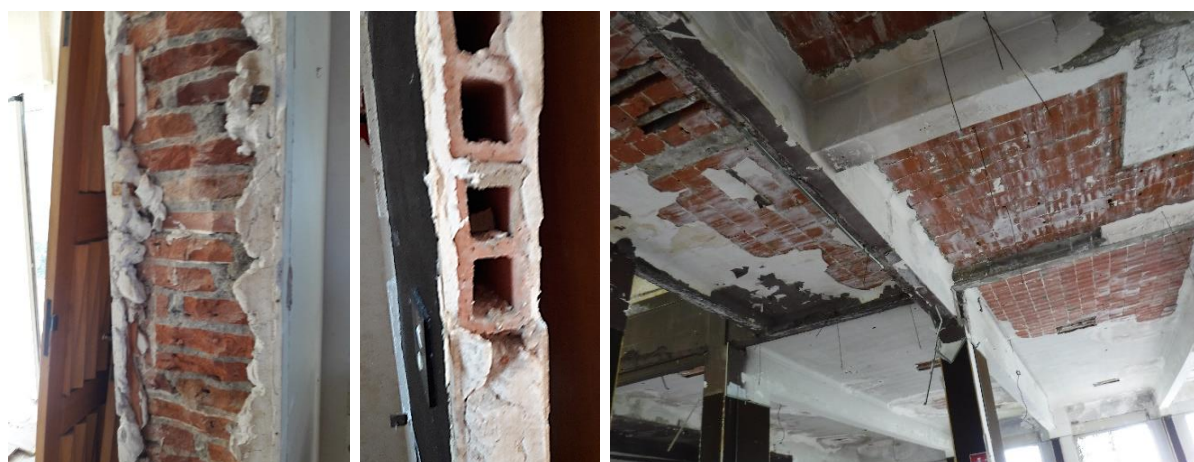
Figure 15 : exemples de déchets brique plâtrière sur les chantiers suivis dans le cadre de l'étude
