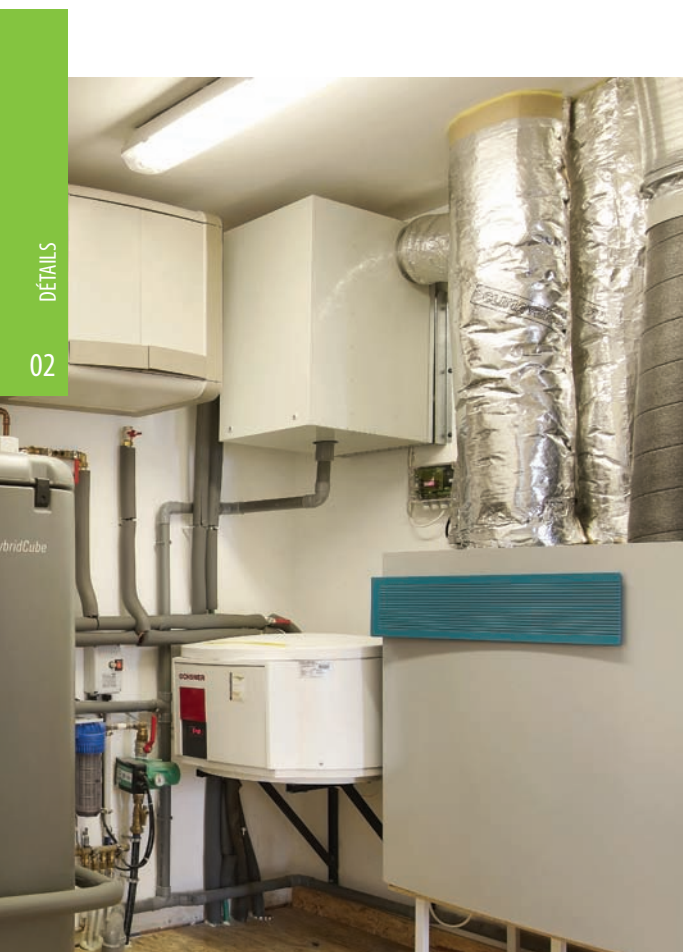
Local technique dédié à la ventilation | Maison individuelle labellisée | Neuville-en-Ferrain (59)
